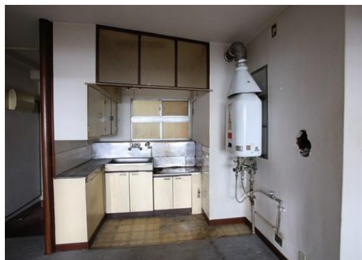
老朽化したキッチン。給湯器は屋内型
