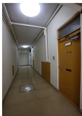
改修を繰り返し配管が露出した中廊下
